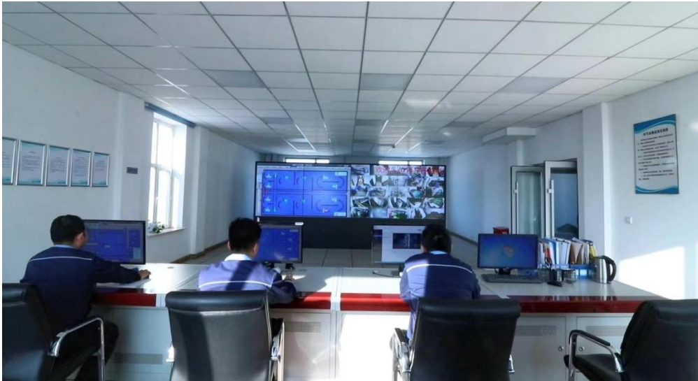
富锋污水处理厂中控室
