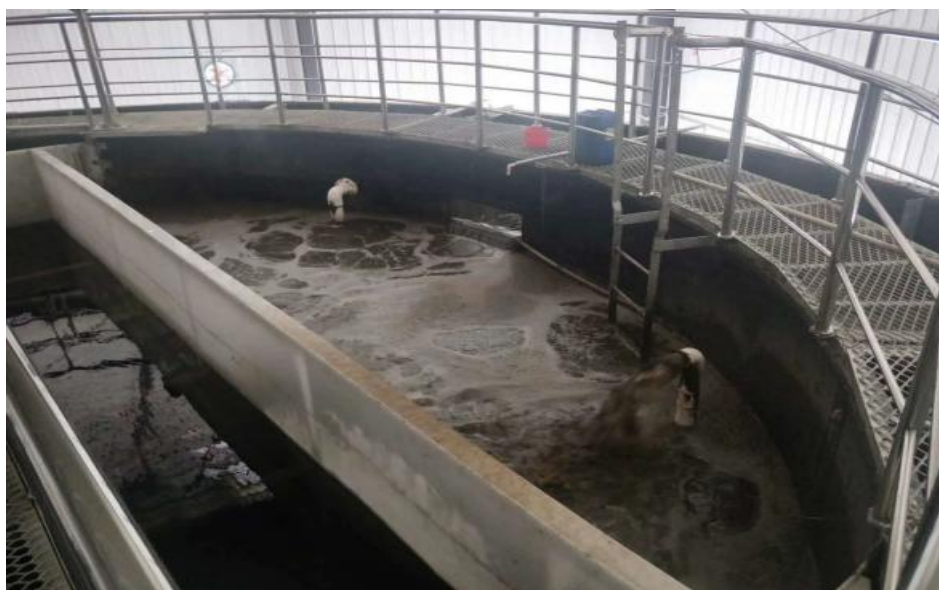
农安县新农乡污水处理站 VFL 一体化设备生化区
